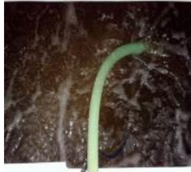
hladina při správné funkci provzdušňování
